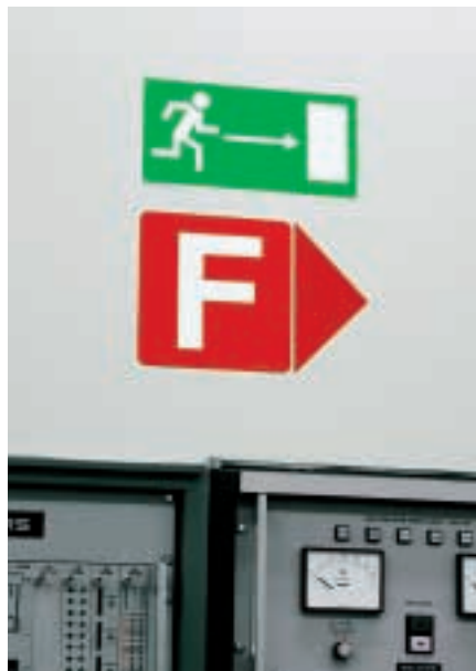
Figure 21 Signal de direction de l'issue de secours, associé au signal de direction du poste de matériel de lutte contre l'incendie.
