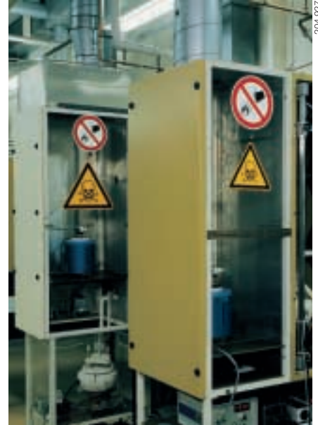
Figure 20 Local dans lequel les signaux de sécurité «Défense d'éteindre avec de l'eau» et «Danger: matières toxiques» sont placés à proximité immédiate des endroits dangereux.
