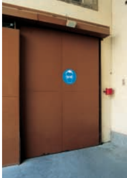
Figure 19 Signal d'obligation sur la porte d'entrée de la zone dangereuse
