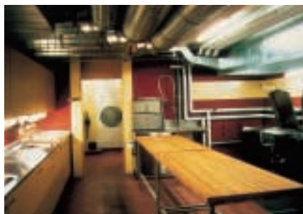
Figure 29 Eclairage d'un local au moyen de tubes fluorescents
