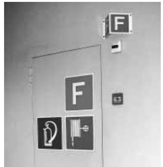
Figure 2: signalisation du matériel pour la lutte contre les incendies
